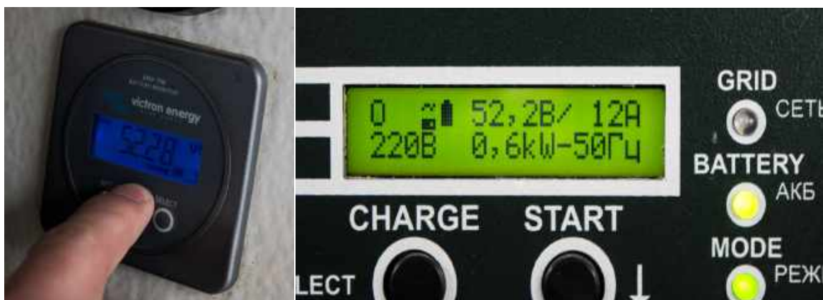
Рис. 3. Показания батарейного монитора (1) и инвертора (2).
